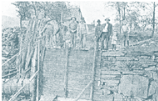
Des ouvriers reconstruisant l'un des barrages du ruisseau Powell alimentant les deux moulins (probablement entre 1910 et 1917).
