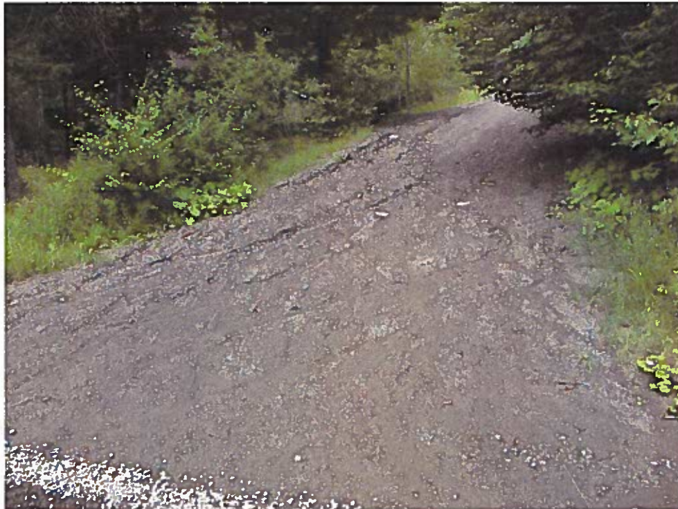
Figure 2 : Crevasses sur la surface de roulement du chemin (rue des Lilas)
