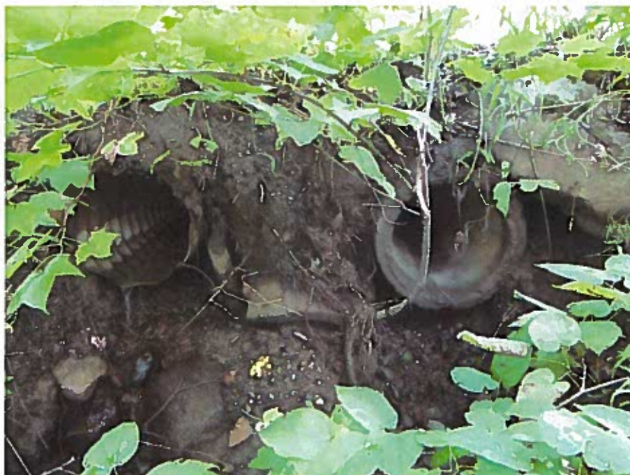
Figure 6 : Ponceaux sous-dimensionnés (rue des Frênes)
