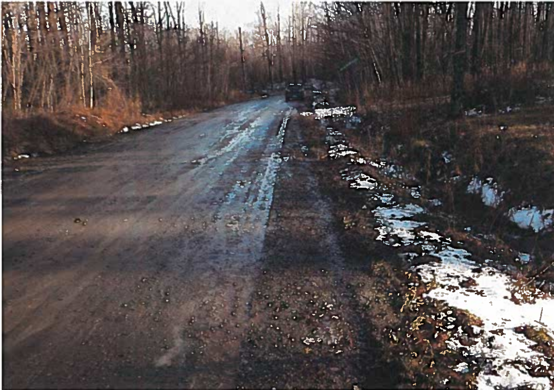
Figure 1 : Chemin boueux (rue des Ormes)
