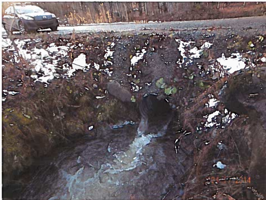
Figure 5 : Érosion des talus du ponceau (rue des Chênes)
